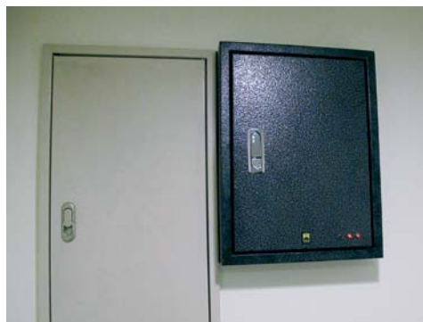
▲主電箱旁加裝了音響專用電箱。
